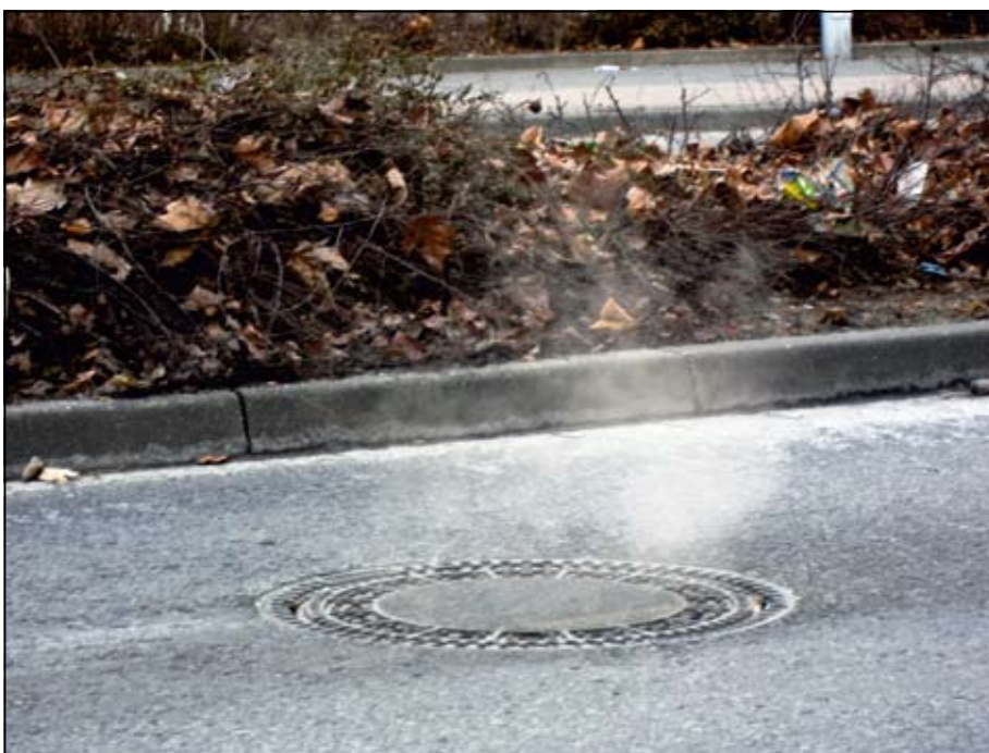
Dampfaustritt aus der Kanalisation
